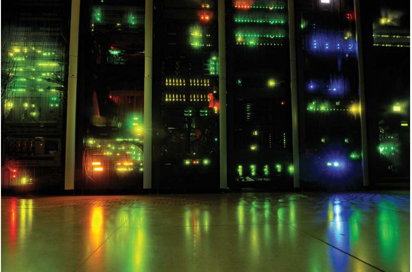
Ensemble de serveurs au sein d'un centre de données
