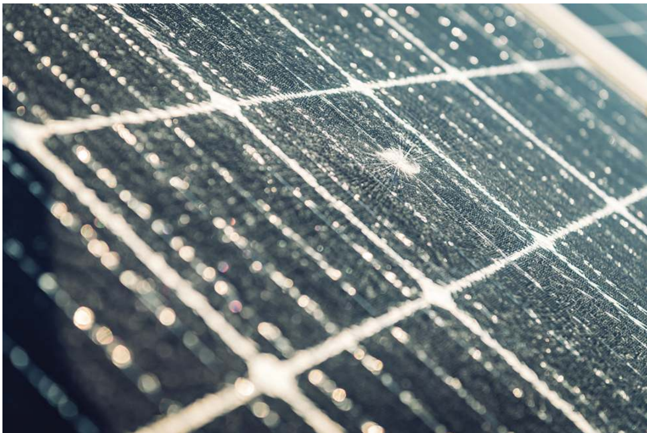
Détail d'un panneau photovoltaïque en toiture de l'Institut photovoltaïque d'Ile-de-France (IPVF) © Cyril FRESILLON / IPVF / CNRS Images
